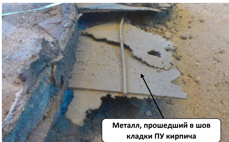
Рис. 3.40. Металлический фрагмент, извлеченный из шва кирпичной кладки.
