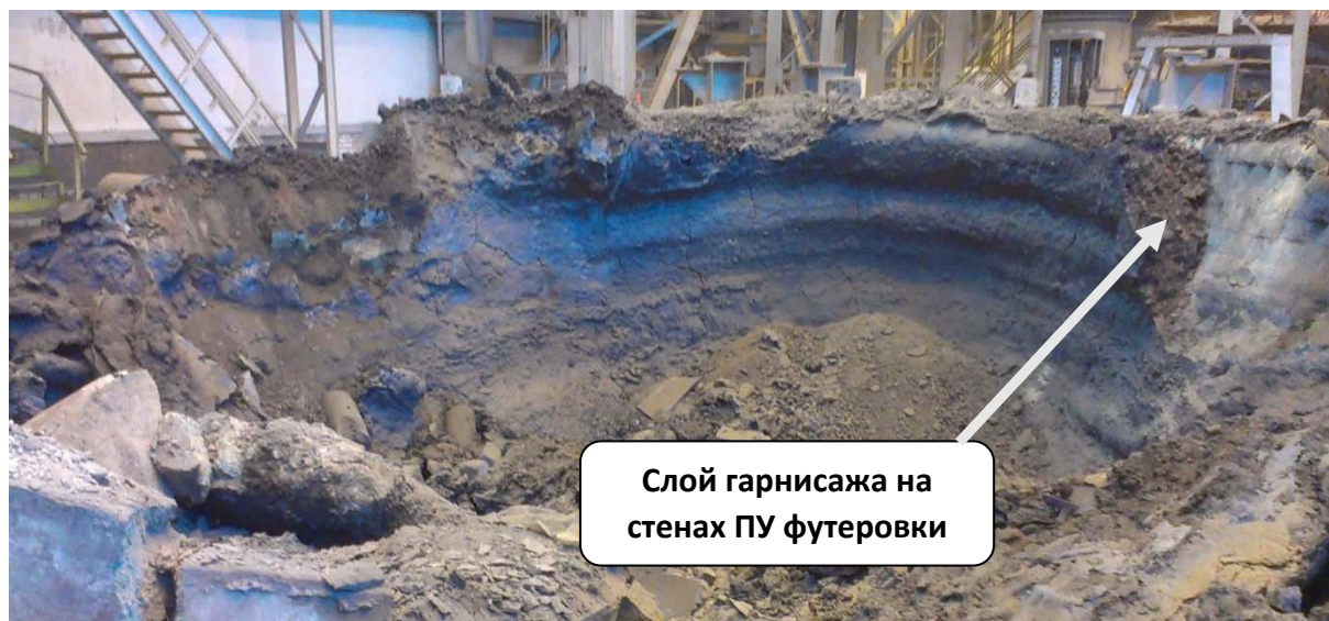
Рис.3.43. Состояние футеровки ДСП после окончания кампании (610 плавов).
