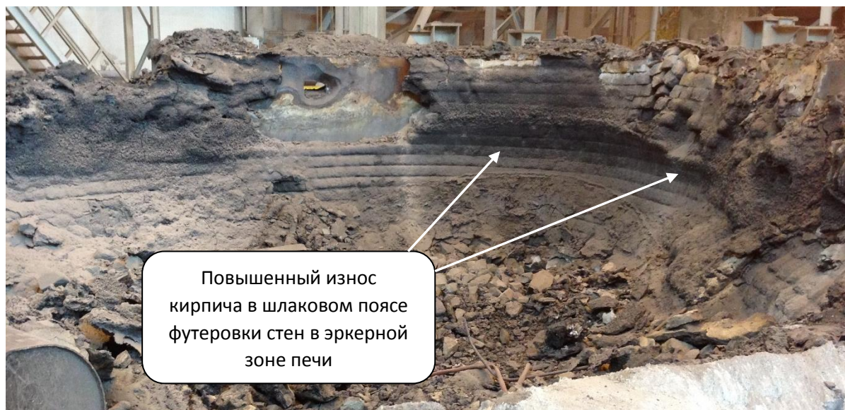
Рис. 4.7. Состояние футеровки ДСП-150 после выпуска 508 плавов при эксплуатации печи с использованием ГБЖ в завалке.
