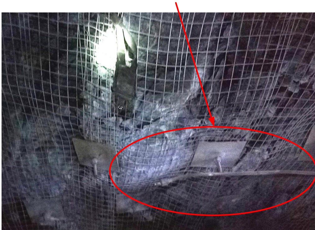
Рисунок 1.8 – Фотография месторасположения трубопровода и форсунки, размещенные под кровлей горной выработки
