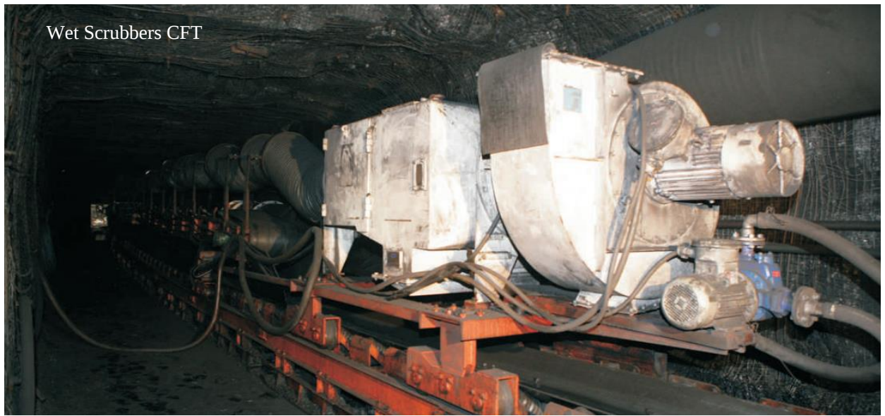
Рисунок 1.16 – Система пылеудаления Wet Scrubbers CFT в месте перегрузки угля с одной конвейерной ленты на другую [27]
