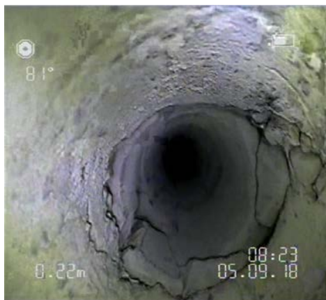
Рисунок 1 - Зоны трещинообразования и ослабления пород кровли
