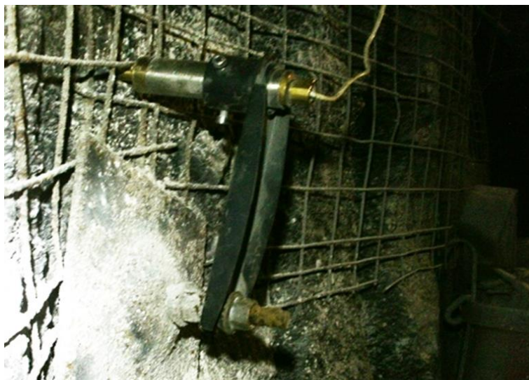
Рисунок 2.3 – Вариант установки регистрирующего геофона в подготовительных горных выработках угольных шахт АО «СУЭК-Кузбасс»
