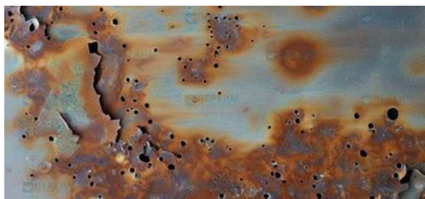
Рисунок 1.8 – Язвенная коррозия на стальной детали [39]
