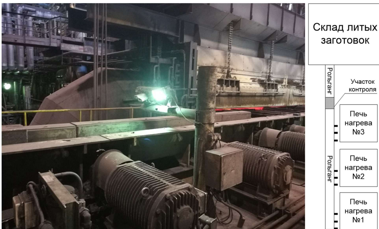
Рис. 21 – Участок контроля НЛЗ
